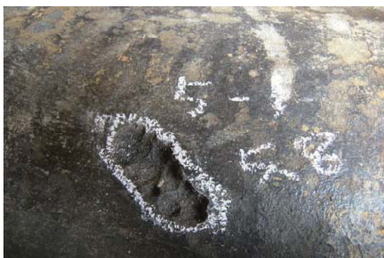
管体調査で明らかになった腐食の進んだ水道管(鑄鉄管)
