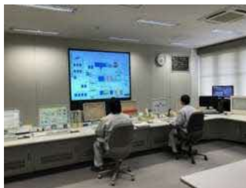
来原浄水場中央監視室
