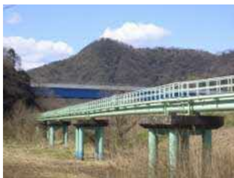
岩棚池水管橋（導水管）
