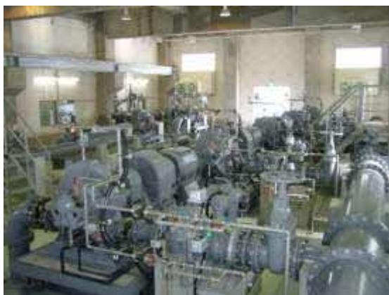
来原浄水場送水ポンプ室
